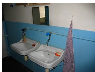
ZŠ – chybějící přívod teplé vody a mýdla v dávkovači; nevhodné řešení osoušení rukou
