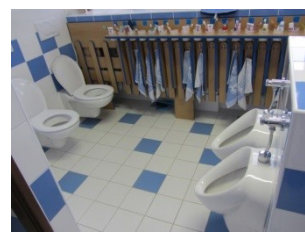
MŠ - nevhodné umístění ručníků a zubních kartáčků v blízkosti WC (při splachování vzniká infekční aerosol)
