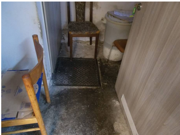
Znečištěný povrch podlahy
