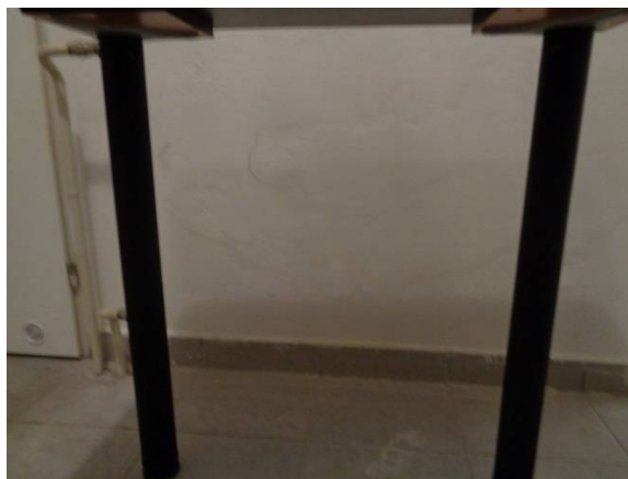
Malba na chodbě při kontrole 21. 11. 2017
