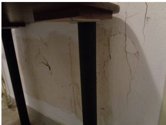
Malba na chodbě při kontrole 1. 11. 2017
