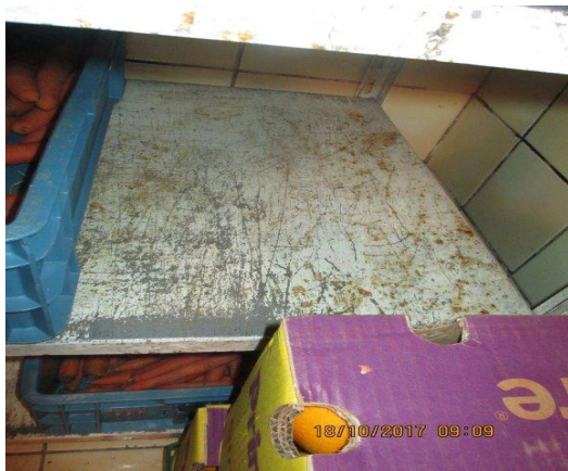
Oprýskaný, zkorodovaný povrch regálů
