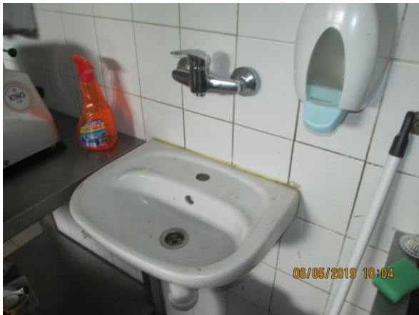
Nefunkční umyvadlo v kuchyni
