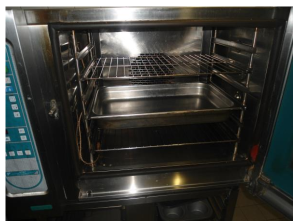
Vyčištěné technologické vybavení
