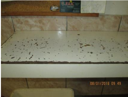
Poškozený, oprýskaný nátěr poličky
